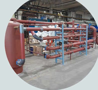
KWO-installatie in het atelier van SPIE.
